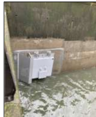
逆流防止ゲート （フラップゲート）
