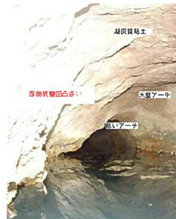
図1 0°方向の坑壁と北側の空洞
