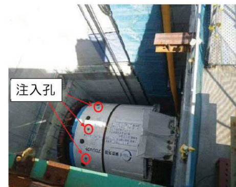
シールドマシンに搭載している滑剤設備
