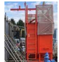
排泥タンク 排泥の貯留
