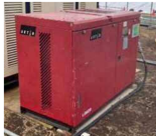
コンプレッサー 排泥圧送用エア
