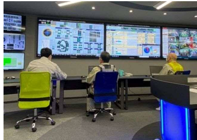
監視モニターでリアルタイム監視(参考例)
