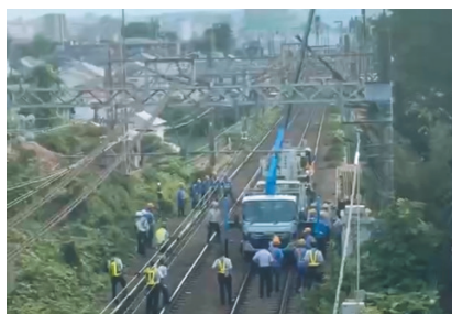
7年8月7日京王線線路脇樹木の倒木事故現場
