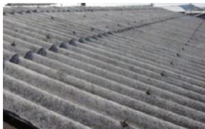
アスベスト含有スレート（波板）
