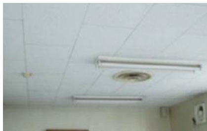
アスベスト含有化粧ボード（天井）
