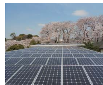
調布ヶ丘地域福祉センター屋上に設置した太陽光パネル
