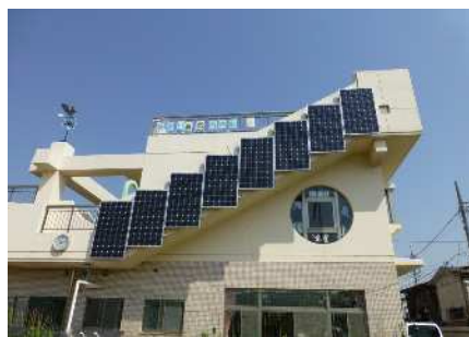
多摩川自然情報館の壁面の太陽光パネル
