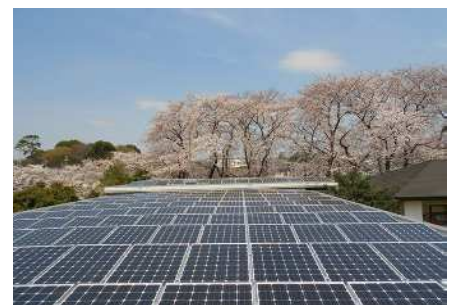
調布ヶ丘地域福祉センターの屋上の太陽光パネル
