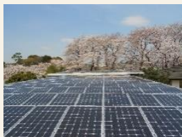
市の施設にある太陽光パネル
