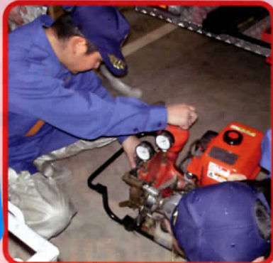
可搬ポンプの点検も欠かさない
