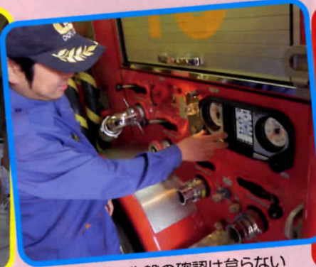
ポンプ操作盤の確認は怠らない
