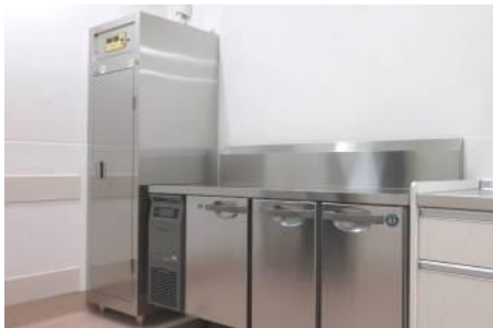
■ 消毒保管庫・冷凍冷蔵庫
