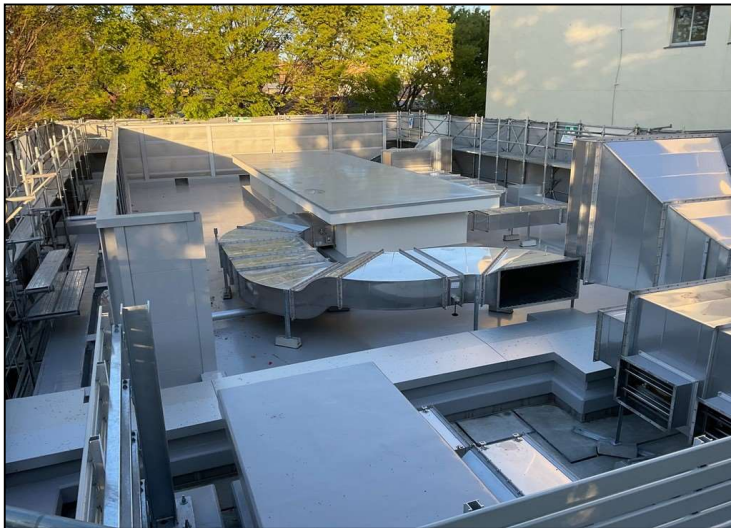
No.2 調布市立多摩川小学校給食室改修工事 屋上設備機器 設置状況
