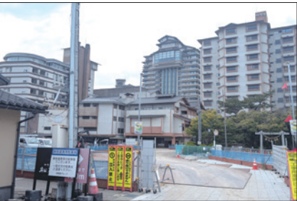
地震で被害を受け、解体を待つ建物（石川県七尾市）
