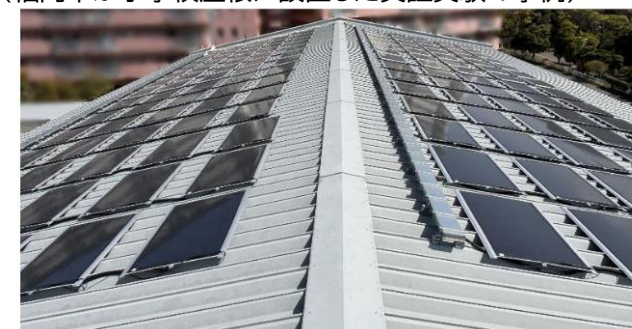
出典:福岡市ホームページ 「国産ペロブスカイト太陽電池の国内最大規模での実装スタート！」
