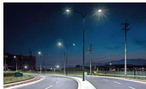
図 LED 照明導入による消費電力削減
