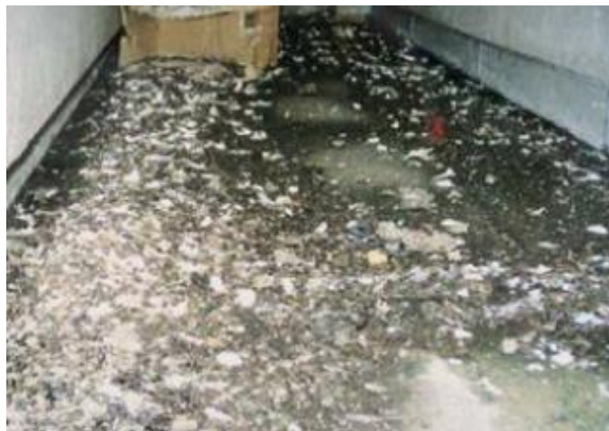
ハトのフンによる通路の汚れ 出展：東京都環境局
