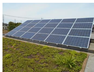
深大寺分館の太陽光発電システム
