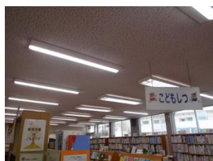
緑ヶ丘分館のLED照明
