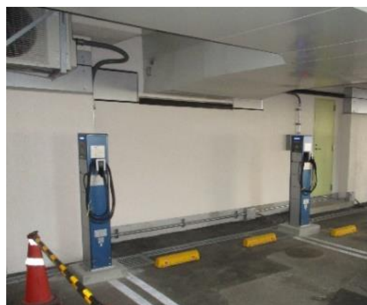
EV充電スタンド
