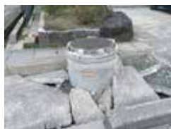
マンホールの浮き上がり
