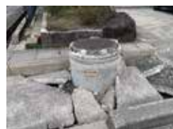
マンホールの浮き上がり
