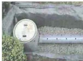
浸透トレンチ
