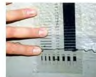
例: 亀裂損傷調査
